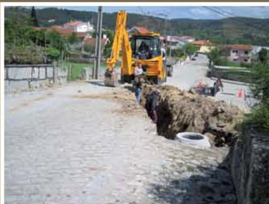
Rede de águas pluviais na rua Cruz das Almas, no Eiró
